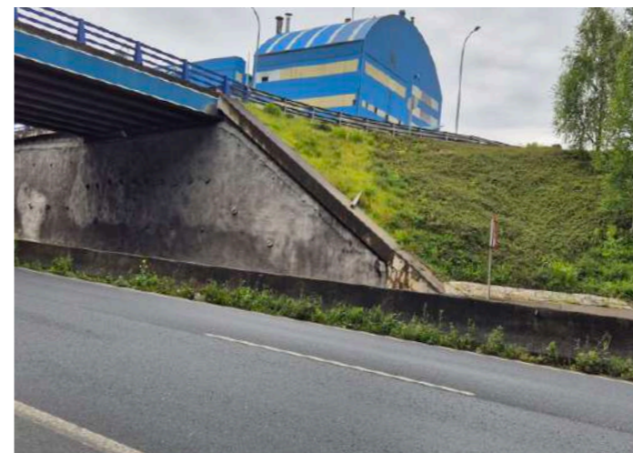
Ctra. Baños de Arteixo a la altura de la empresa Resonac
