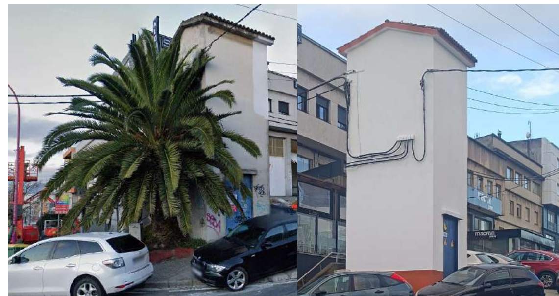
Transformador en calle Gutenberg
