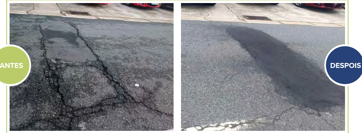
■ Reparación bache en José María Rivera Corral
